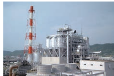
広島事業所 バイオマスボイラー
