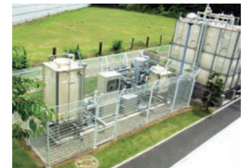
分散型水処理・給水システム
