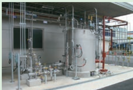
増設した実習プラント
