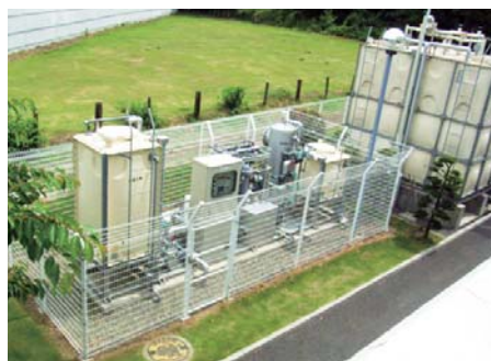
分散型水処理・給水システム
