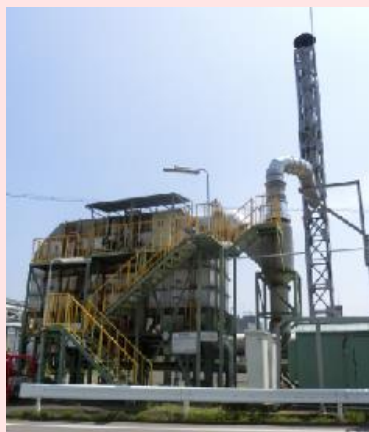
6 蓄熱式燃焼脱臭装置 (RTO)
