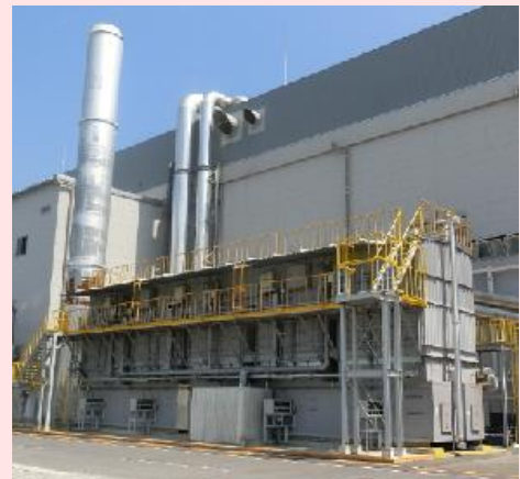
7 蓄熱式燃焼脱臭装置 (RTO)
