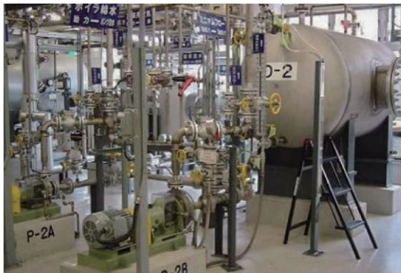
温水循環プラント
