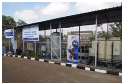
ルイル市内に給水中の膜ろ過システム(2015)
