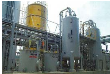
塩水2次精製装置 2塔式
