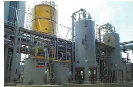
塩水2次精製装置 2塔式
