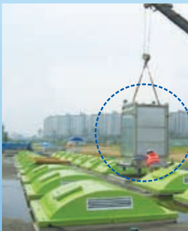
下水処理施設に設置される中空糸膜フィルター《ステラポアー》
