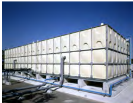
貯水タンク「ヒシタンク®」
