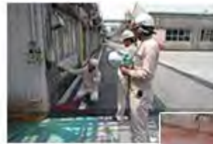
圧縮空気漏れ調査
