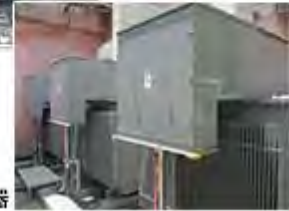
更新後の変圧器
