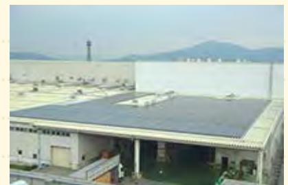
工場建屋の屋根上に設置した太陽光パネル
