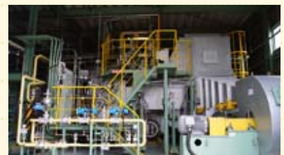
改造工事を実施したボイラー
