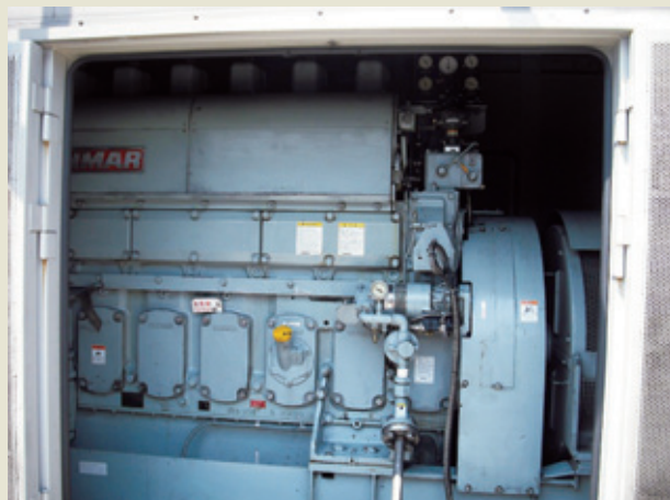
郡山製造所のコジェネレーション
