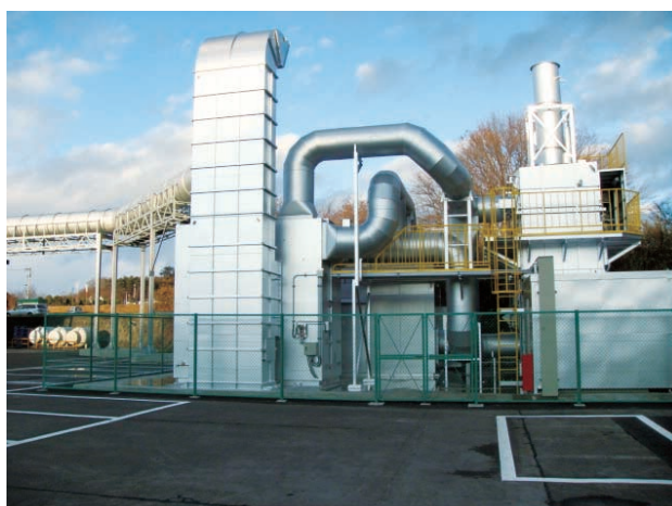
VOC除去装置
