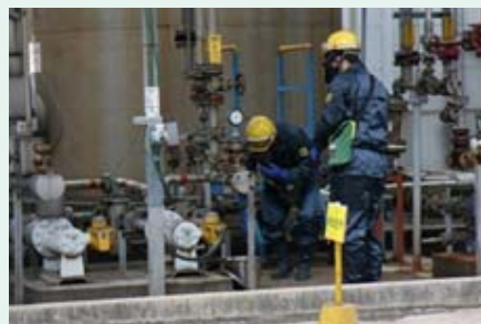
(2) (1)の処置中に別の設備での危険物漏洩を想定した処置
