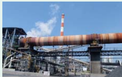
排ガス燃焼装置
