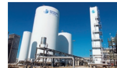
マチソントライガス社(米国) 空気分離装置
