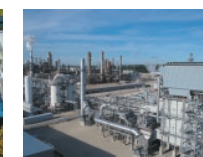
水素を供給する「HyCO プラント」
