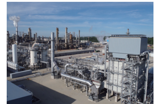
水素を供給するHyCOプラント
