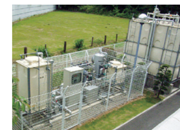
地下水膜ろ過システム
