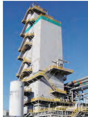
省エネルギー型超大型空気分離装置
