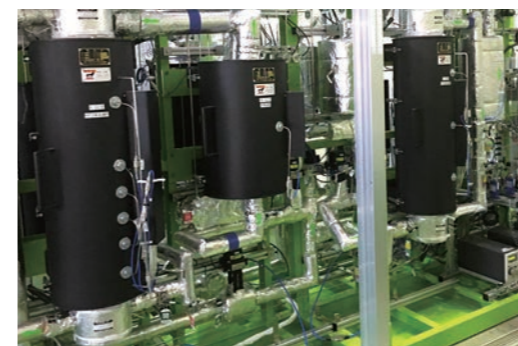
オレフィン合成小型パイロット設備
