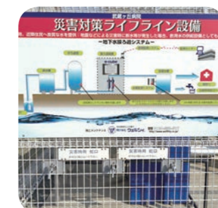
熊本地震時に使用された災害時非常用蛇口と災害対策ライフライン設備の看板（武蔵ヶ丘病院）
