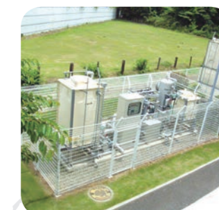
地下水膜ろ過システム
