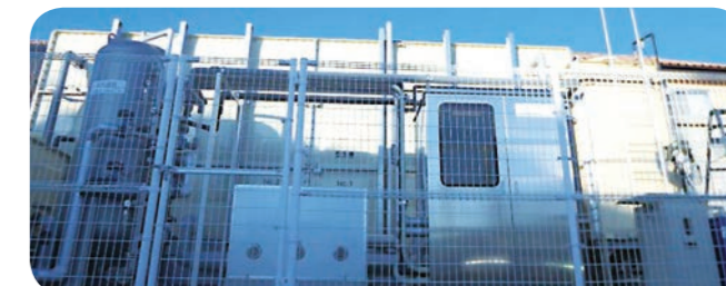
熊本地震時も稼働し続けた地下水膜ろ過システム（武蔵ヶ丘病院）
