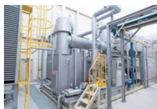
長浜工場のコージェネレーション設備
