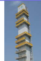
水- 18 O製造プラント
